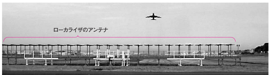
〈写真1〉 (K) ローカライザ用 アンテナ施設
