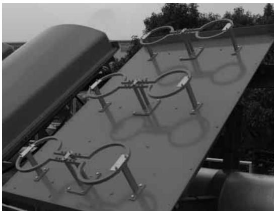
〈写真2〉 パネル内部に納められた3素子2L双ループ・アンテナ (写真提供：清水保定 様)
